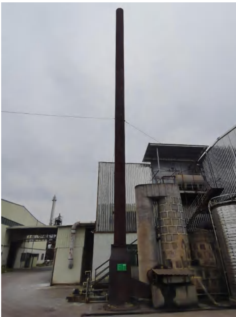
废气处理设施及排放口
