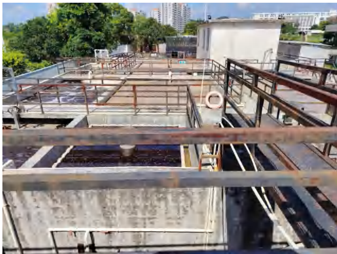
自建废水处理站
