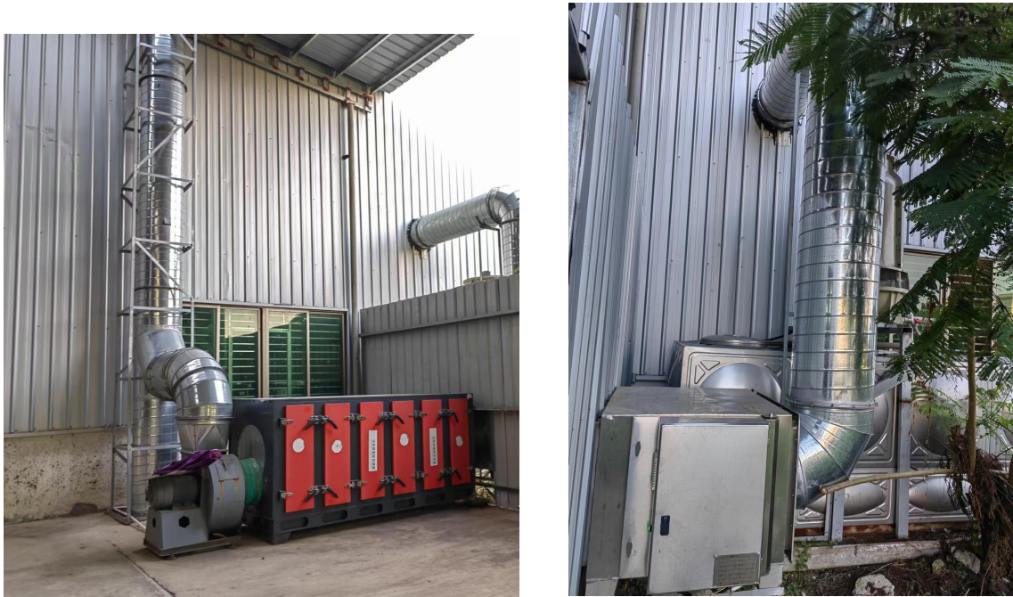
废气处理设施
